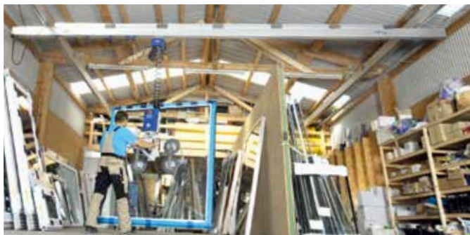
電気チェーンブロックとバキュームリフト「バキュマスター」を備えた木材梁用の天井クレーンシステム
